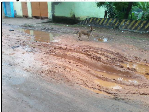
Figura 3.16 – Buraco em Rua do Bairro Planalto.
